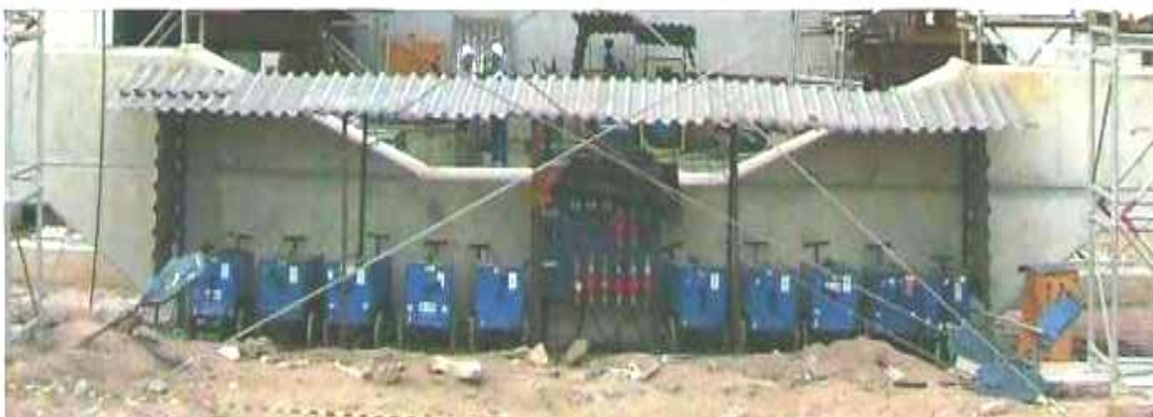
Figura 5.3 – Equipamentos utilizados no processo de soldagem (quadro de distribuição e maquinas de solda).
