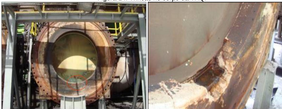
Figura 14: Trincas no corpo da VAQ.
