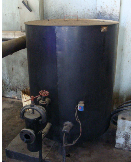
Figura 33 – Reservatório intermediário de óleo Bpf.
