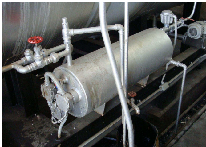
Figura 34 – Aquecedor automático de óleo.
