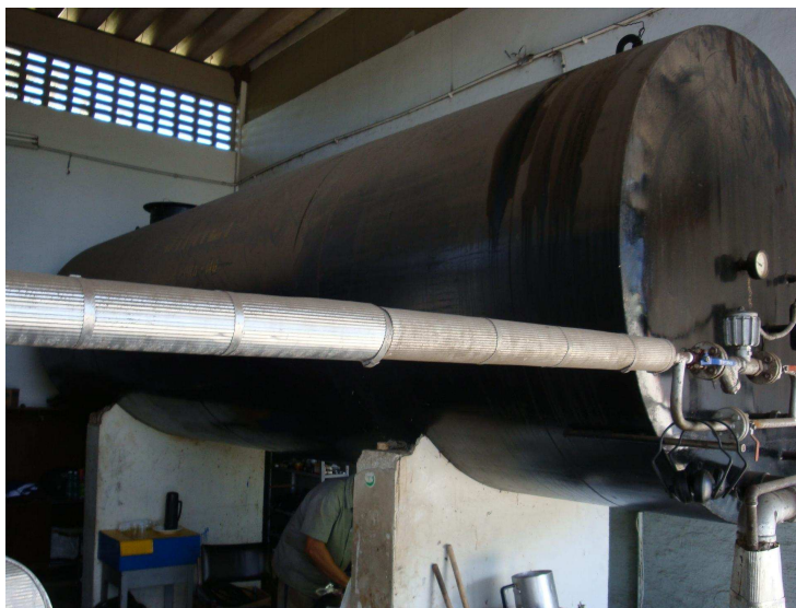
Figura 32 – Tanque para óleo pesado Bpf.
