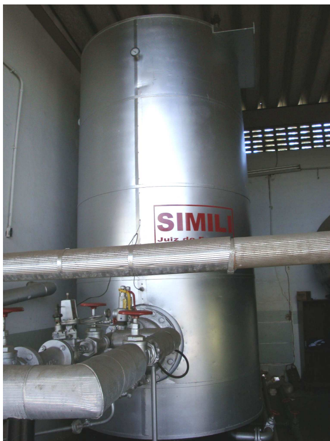
Figura 27 – Trocador de Calor.
