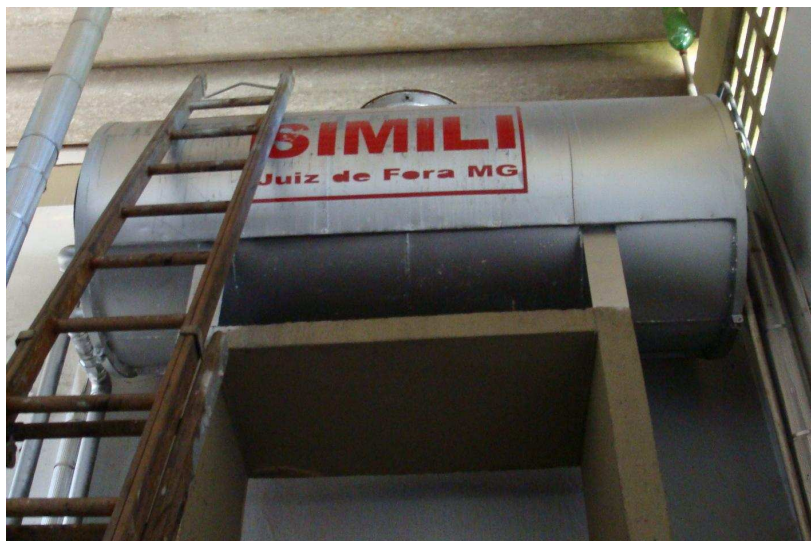
Figura 31 – Tanque de condensado.
