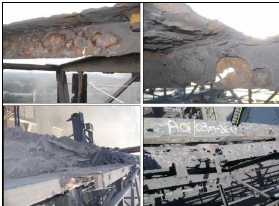
Figura 4.3 - Elementos estruturais da Talha 12PR06 em elevado estado de corrosão.
