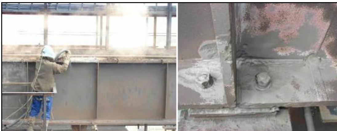
Figura 3.7 - Jateamento abrasivo em viga de rolamento para inspeção (esquerda) e realce da perda de material por corrosão nas bases dos parafusos e abas da viga (direita).
