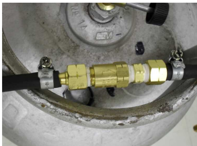
Fotografia 16 – Válvula de Retenção.
