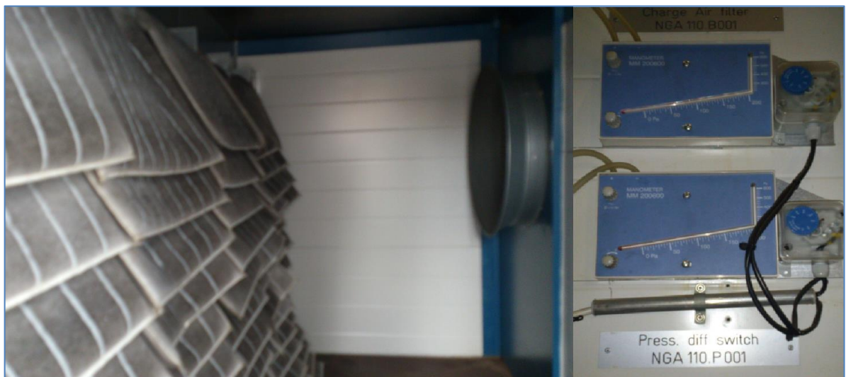
Figura 17 - Filtro de ar do sistema de ar de alimentação e sua instrumentação local.
