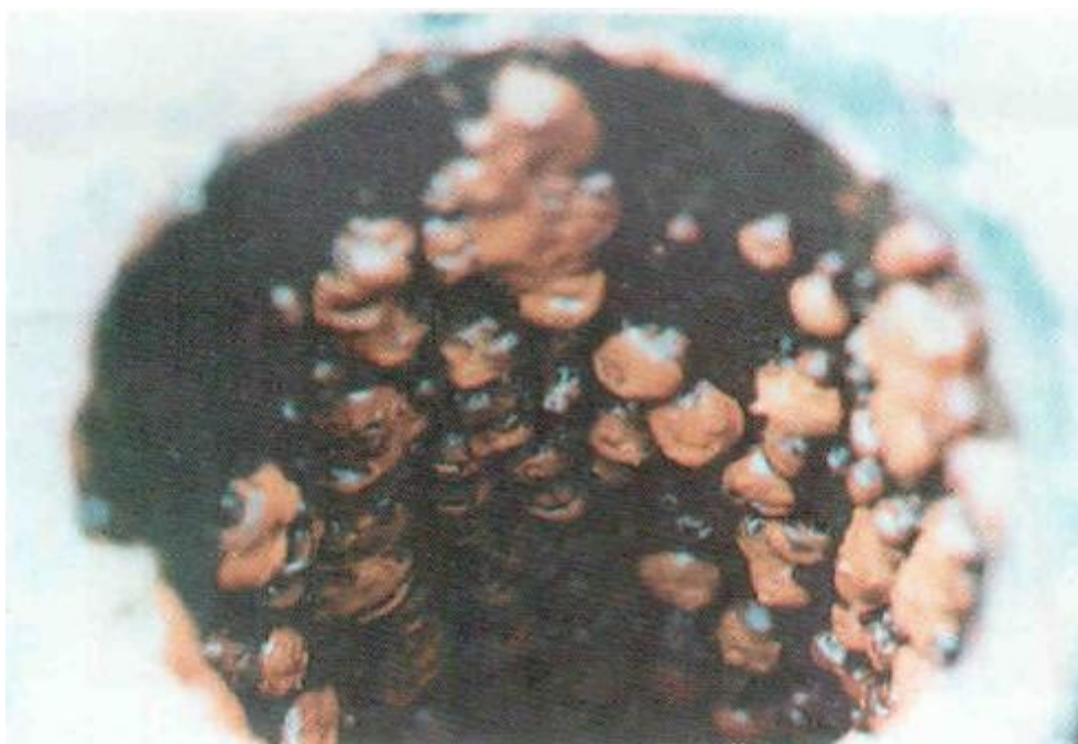
Figura 13 – Tubérculos em tubulação de aço carbono [7]
