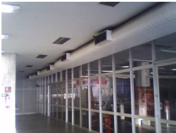
Figura 3.16 – Instalação com duto aparente
