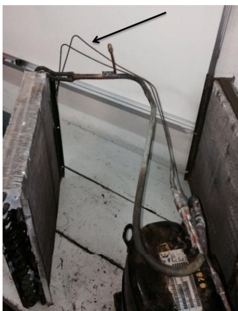
Figura 4.5- Tubo Capilar (indicado pela seta)
