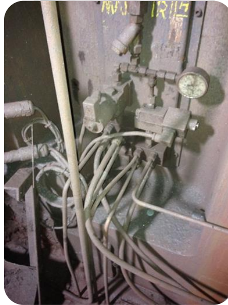
Figura 14 - Distribuidor de lubrificação entre mancais e trilhos Fonte: VALE, 2014.
