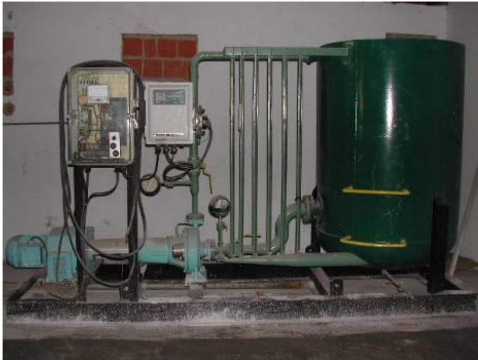
Figura 17. Vista da Bancada antes da Manutenção
