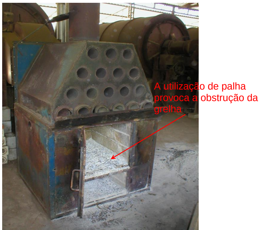
Figura 6 – Obstrução da grelha
