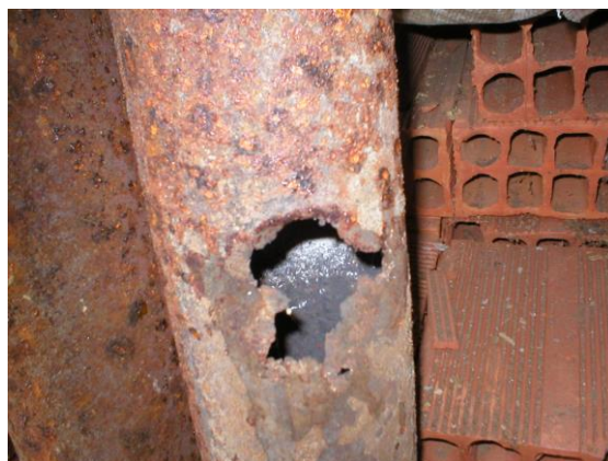
Figura 5.03 – Tubos do trocador de calor perfurados pela corrosão
