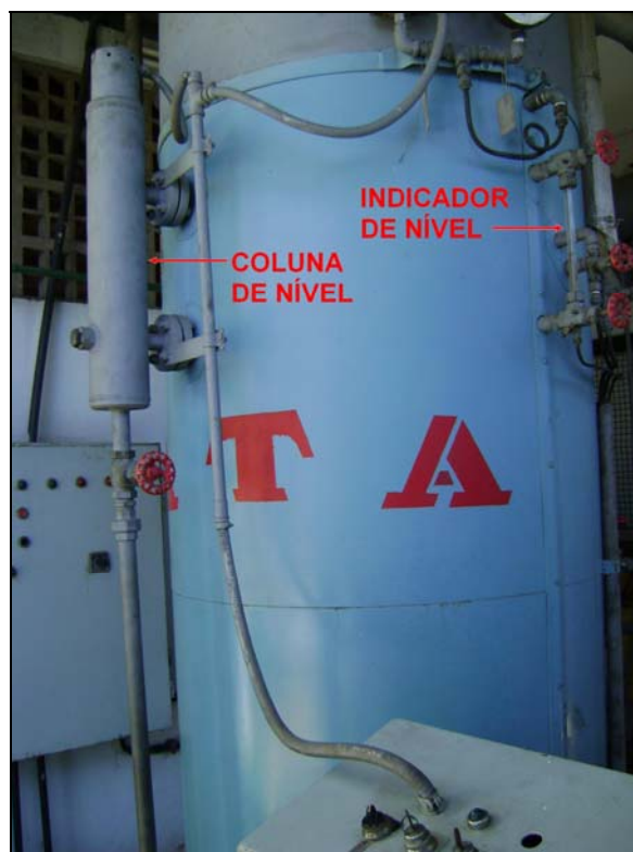
Figura 14 - Corpo da caldeira.
