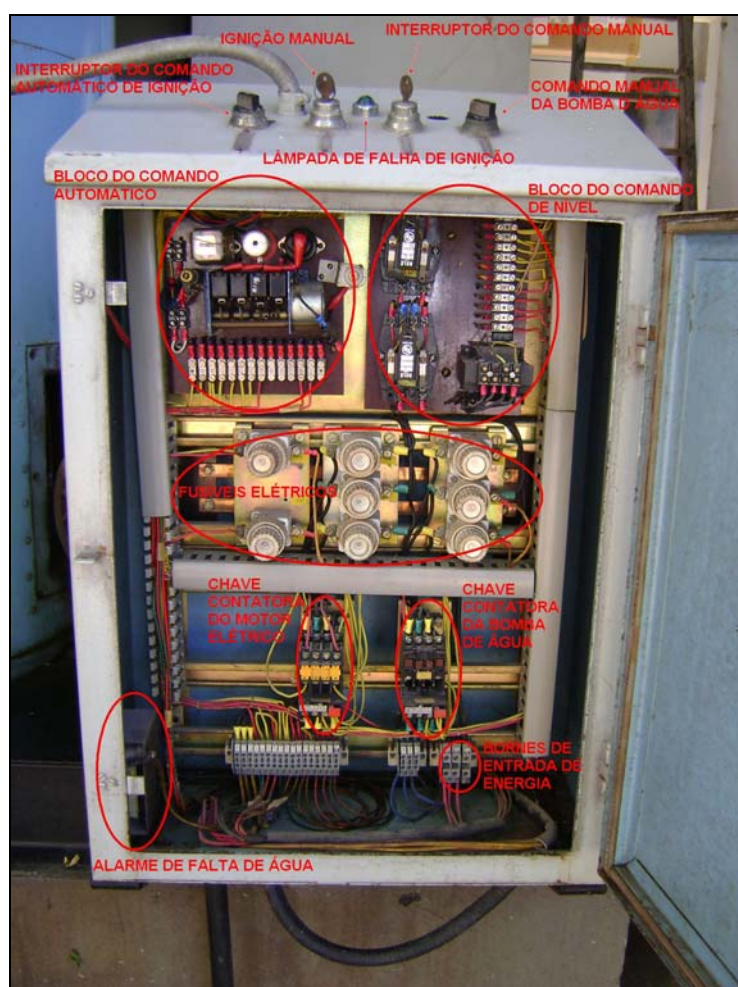
Figura 12 - Painel de Controle.
